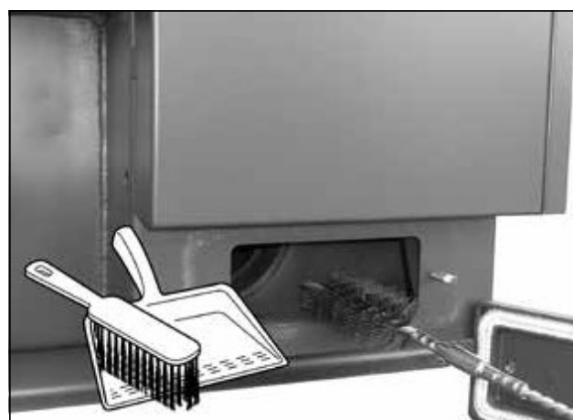
Ukázka čištění kouřového kanálu - spodní víčko
